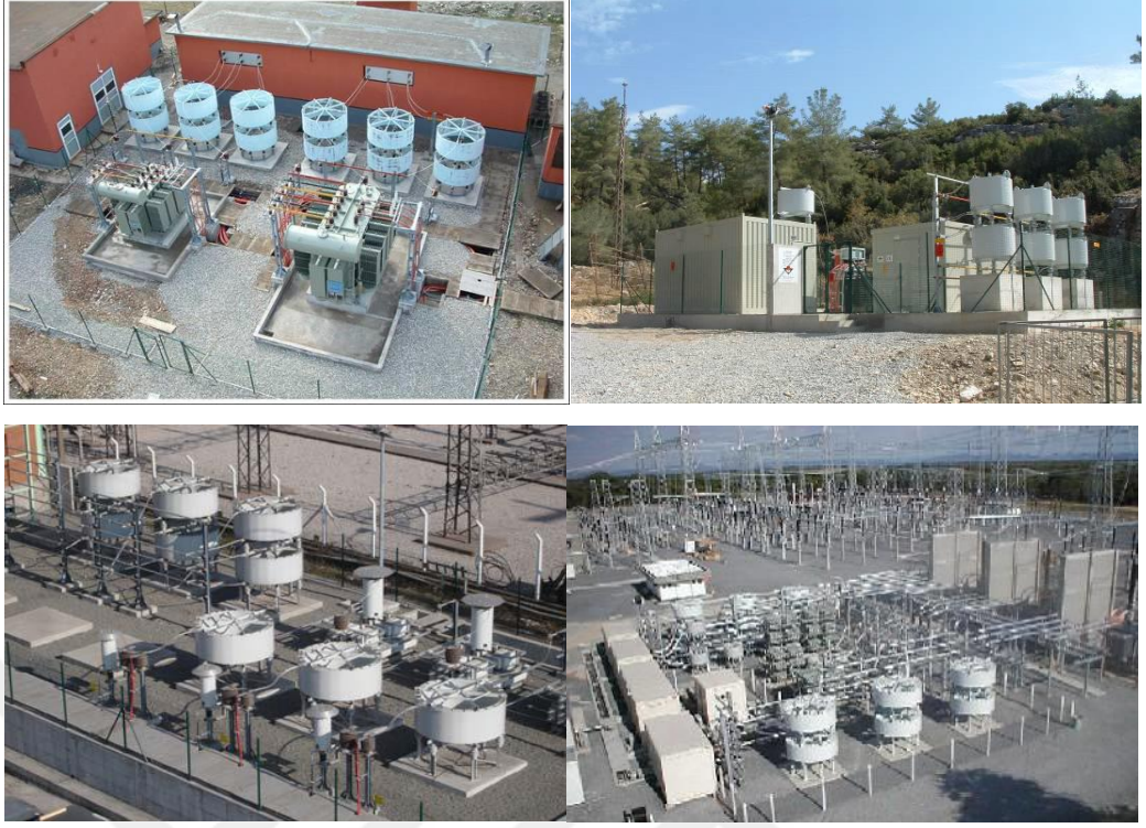
Şekil 3.1 : Değişik tiplerde SVC şalt tesisleri.
