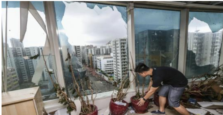
Görsel 2.34. Hong Kong depreminde meydana gelen cam hasarı [45]
