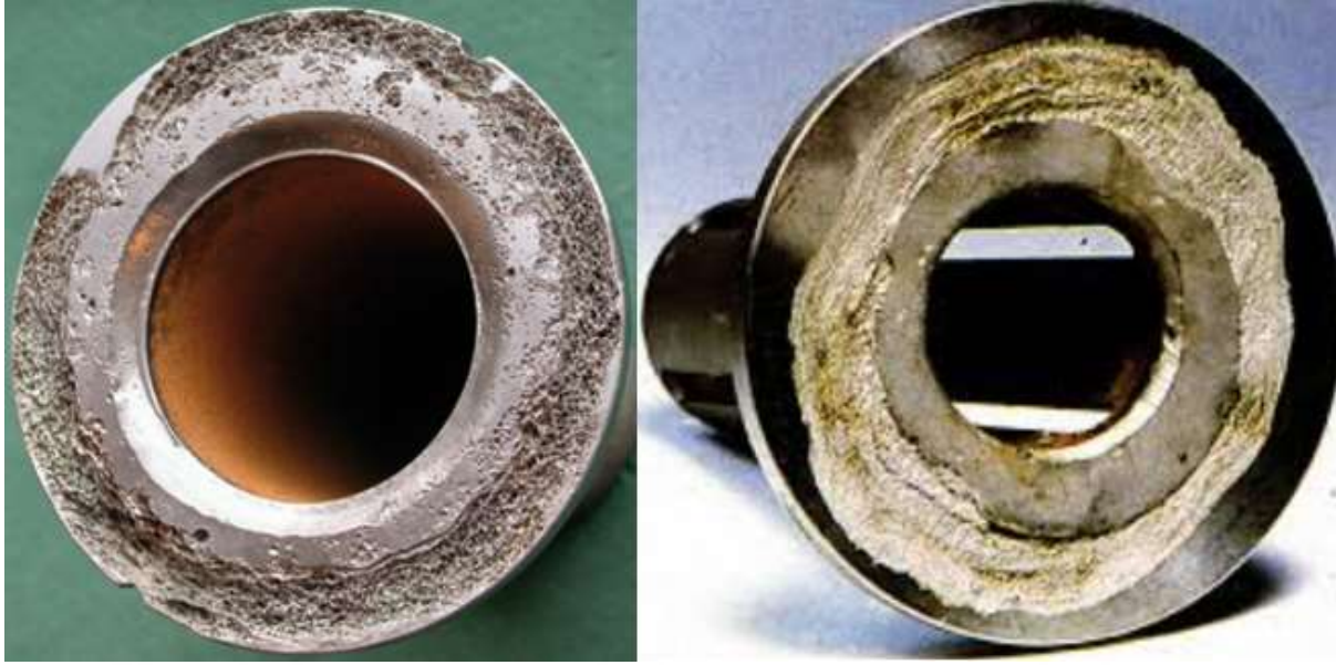
Şekil 2.20. Flanşlar arası aralık korozyonu örneği [59]
