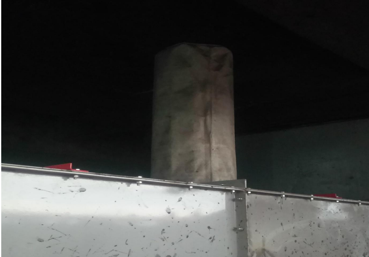
Şekil 4.6. Transfer şutu toz filtresi.
