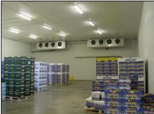
Resim 3: Sođuk Hava Deposu
