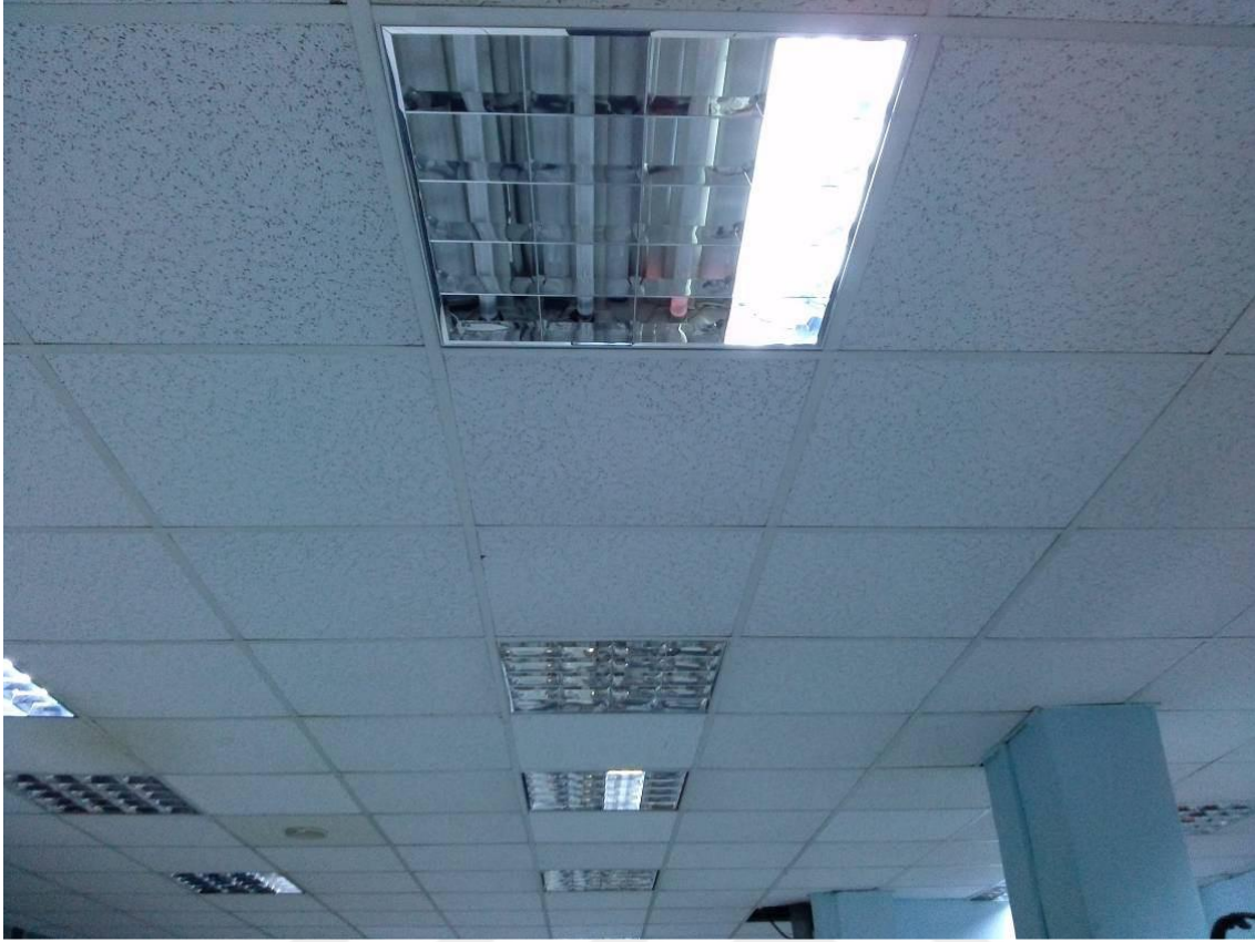
Şekil 2.11. Laboratuvarlardaki yetersiz aydınlatma kaynakları [57]
