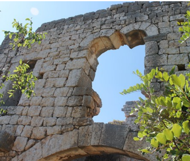
Fig.110 Karakabaklı 2 Nolu Konut, ikinci kat ikiz pencere ve kapı açıklığı
