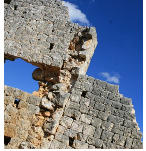
Fig. 102 Karakabaklı 1 Nolu Konuta sonradan eklenen duvarlar
