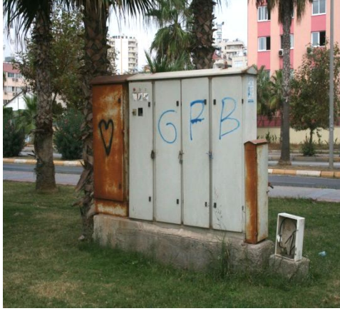
Resim 22- Paslı elektrik trafosu
