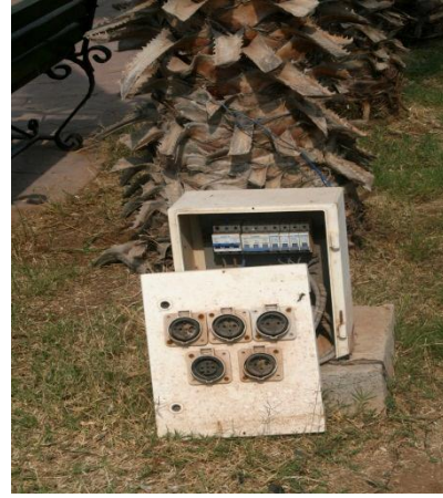
Resim 23- Kapağı açık bırakılmış bir elektrik kutusu
