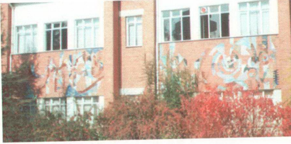
Resim: 34 Sırlı ve sırsız tuğlaların birlikte kullanıldığı bir dış cephe kaplaması, Oya Uzuner, 1992, 3x20 m., Anadolu Üniversitesi Fen Fakültesi.
