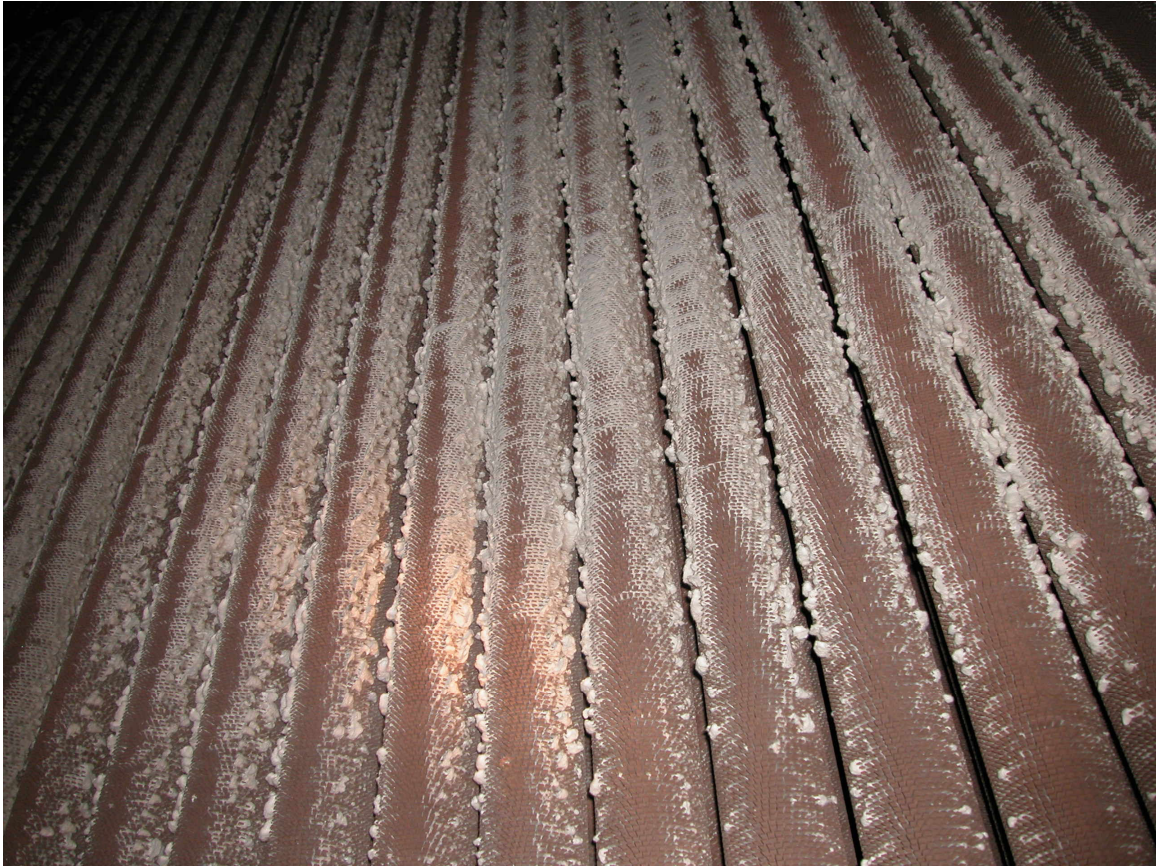
Figure 41: Fouled HRSG Tubes
