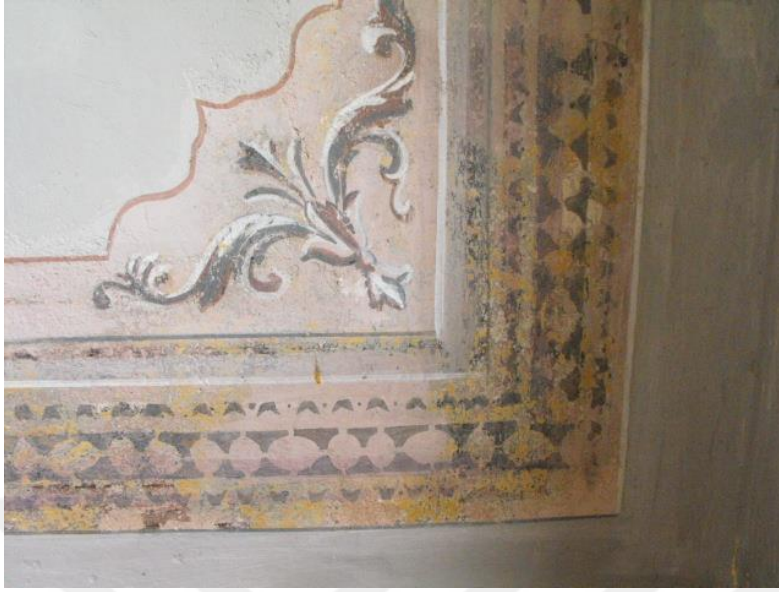
Fotoğraf 3.3.3.13. Halk Kütüphanesi, Kuzeybatı Cephesine Bakan Odanın Duvar Süslemesi, 2014
