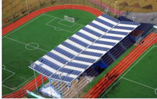
Şekil 2.13: Tribün Çatısında Güneş Paneli Örneği. ( http://www.kocaeli.bel.tr , Erişim: 11.08.2016 )
