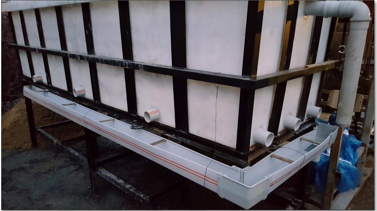
Şekil 3.27: Sızan suyu tek bir noktada toplamaya yarayan oluk.
