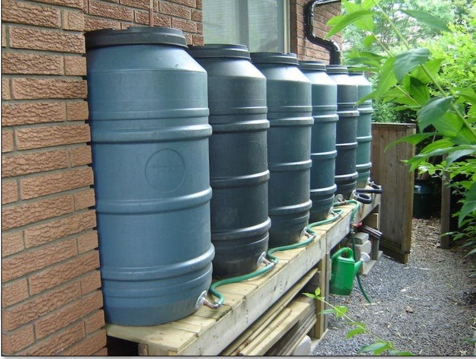
Şekil 2.4: Yağmur tankı uygulaması
