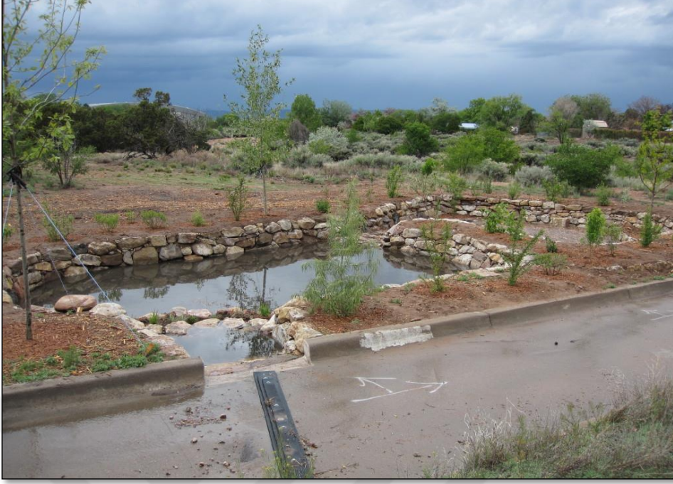
Şekil 2.2: Geçirimsiz yüzey üzerinde oluşan yüzeysel akışın tutulması için yapılan biyotutma uygulaması ( http://www.southwesturbanhydrology.com/wp-content/uploads/2017/01/Camino-del-Bosque-Bio-retention-Basin1.jpg ).
