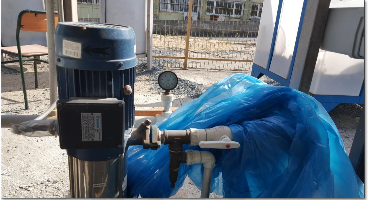
Şekil 3.11: Sisteme su iletimi sağlayan pompa ve debi kontrol vanası.
