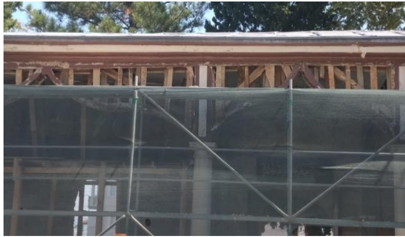
Resim 4.163. Emir Sultan Türbesi Doğu Girişindeki Revakta Ahşap Basık Kaş Kemer İçleri (Foto: H.Gürsel Bilmiş-2019)
