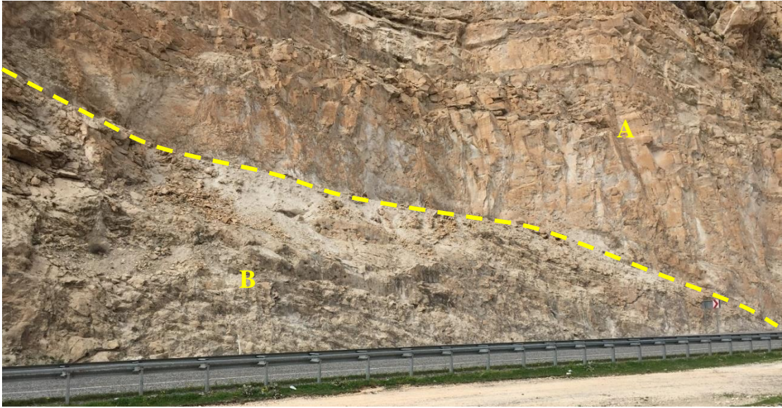
Şekil 2.15: A kesiminin sağlam kireçtaşını, B kesiminin nispeten sağlam kireçtaşını temsil ettiği mostra görünümü (II).
