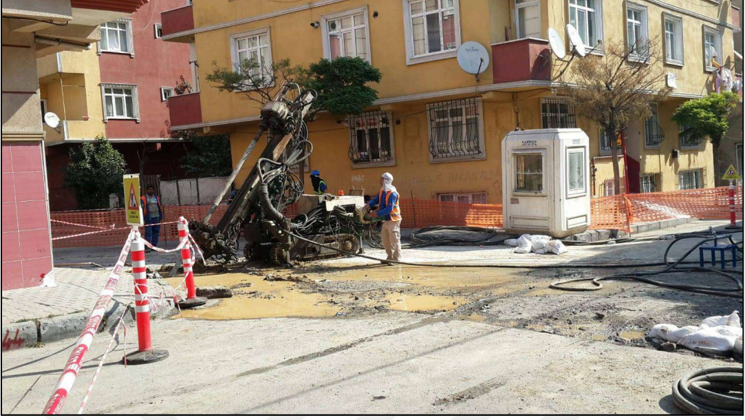
Resim 4-4: Yenimahalle İstasyonu ile Karadeniz İstasyonu arasında yapılan zemin iyileştirme amaçlı enjeksiyon çalışmaları
