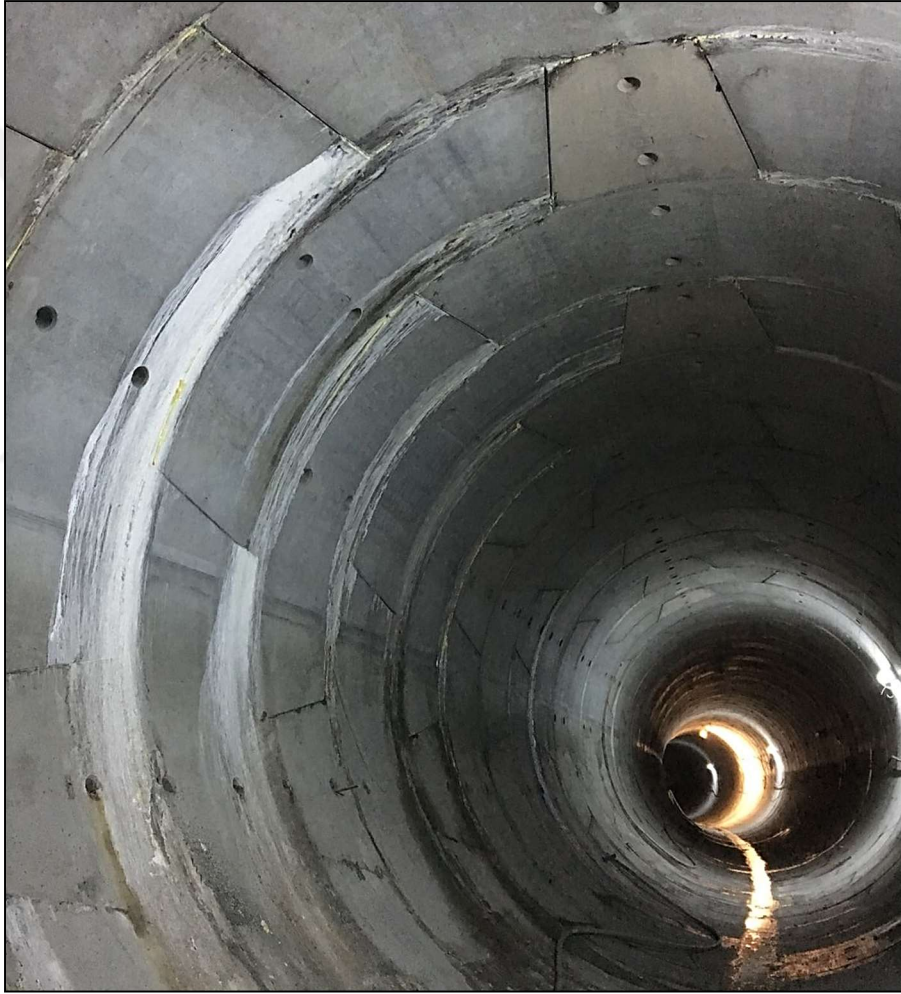
Resim 4-3: Km: 14+750 ile Km: 14+840 arası tünel içi su gelirleri
