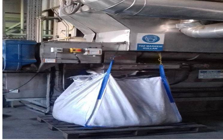
Şekil 3.7: Çamur Kurutma Bölümü
