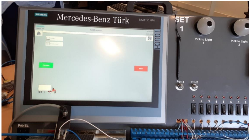
Şekil 3-20 Siemens Simatic HMI Pano görüntüsü(Enerji verildiği durum )
