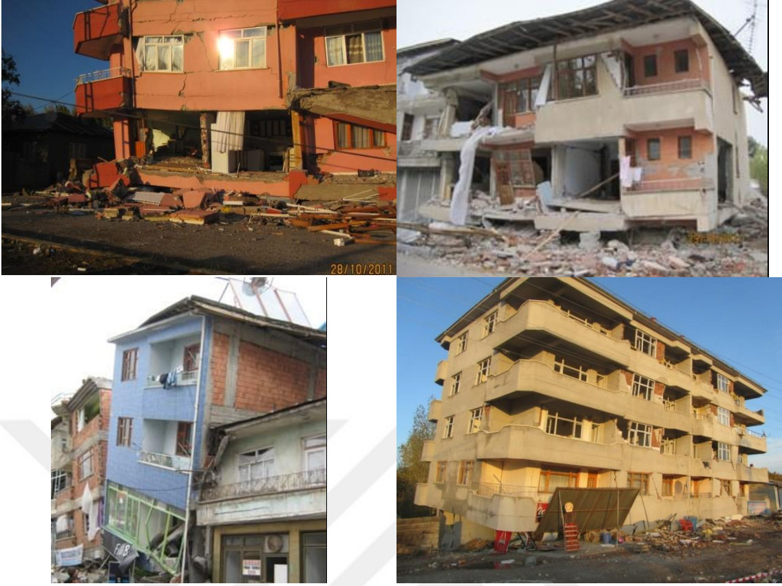
Şekil 1.12. Van Erciş depreminde gözlenen yumuşak kat hasarları
