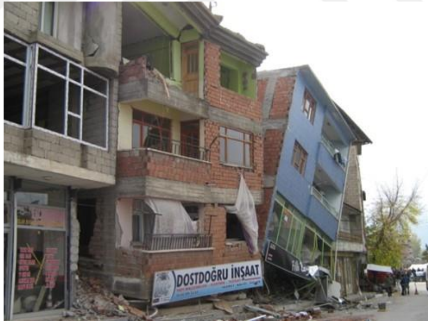
Şekil 1.13. Van depreminde gözlenen yumuşak kat hasarı
