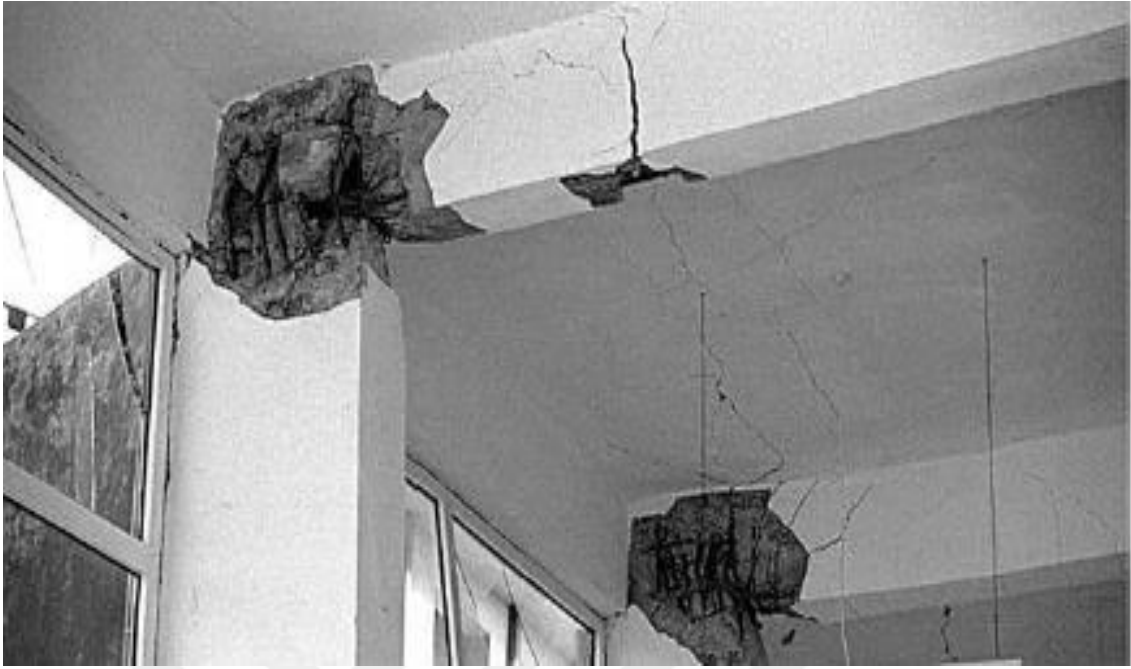
Şekil 3.1. Düğüm noktasında mafsallaşma ve kirişte eğilme çatlağı (Sezen, 2003)
