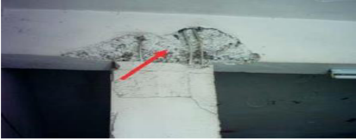
Şekil 3.5. Kolon-kiriş birleşim bölgesinde meydana gelen hasar (Koç, 2016)
