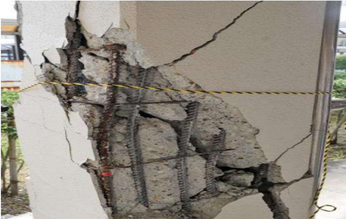
Şekil 3.3. Kolonlarda kesme hasarı
