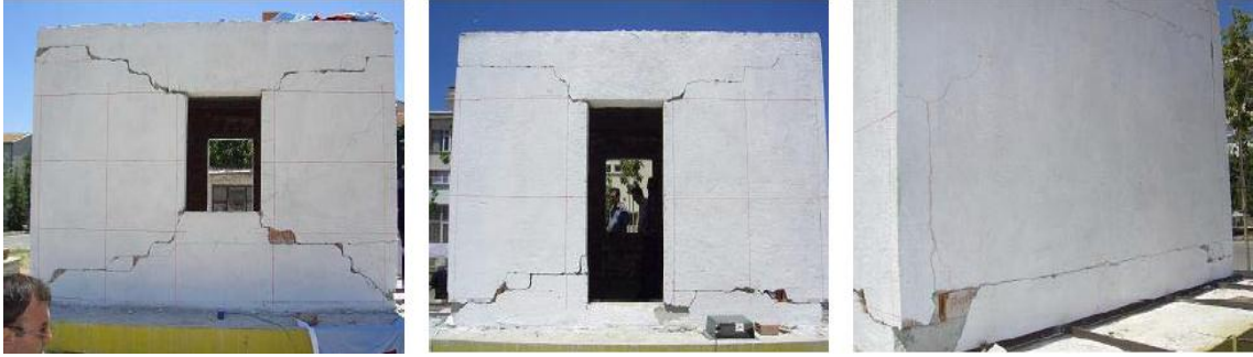
Şekil 2.8. Hasarlı deney yapısının görünüşü (Altın ve ark., 2005)
