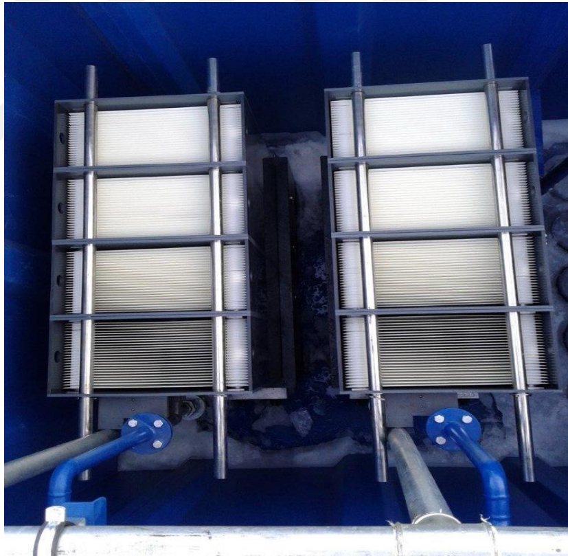
Şekil 3.10. Aerobik bölge içerisindeki membran kasetleri
