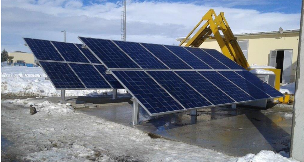
Şekil 3.11. Güneş enerji panelleri
