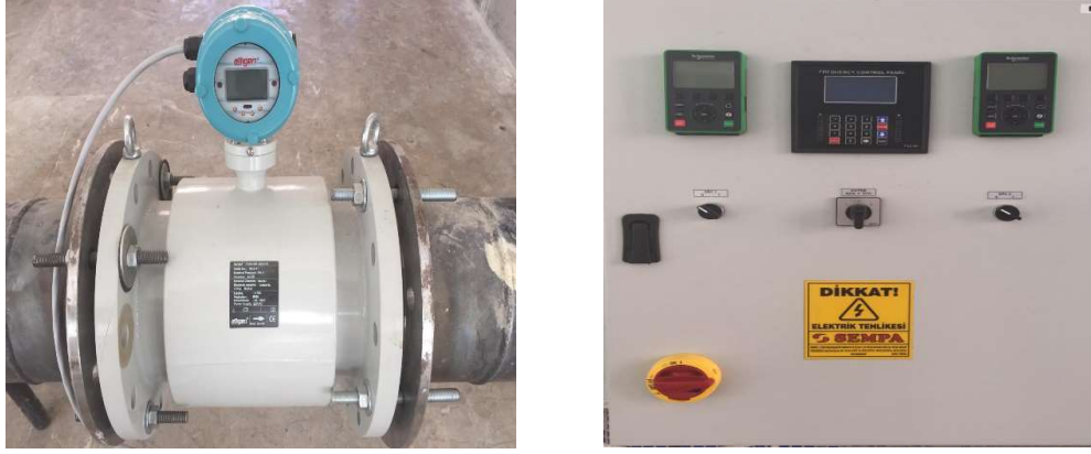
Şekil 3.13a) Elektromanyetik debimetre cihazı, b) Frekans değıştirci kontrol panosu
