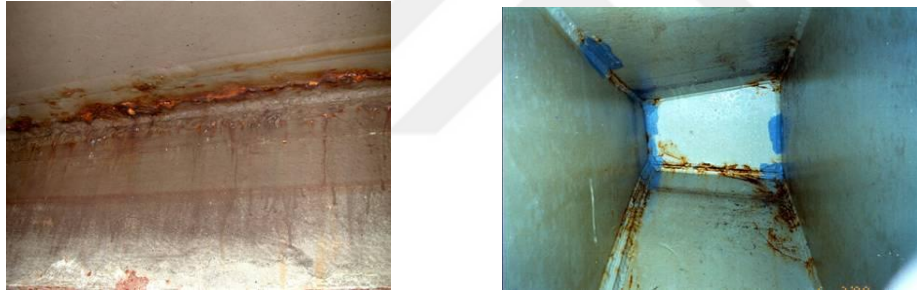
Şekil 1.3. Çelik yapılarda kaynaklı birleşimlerde kaynaklarda gözlenen korozyon hasarı ( http://www.amteccorrosion.co.uk/m_coatingfailuresguide.html )
