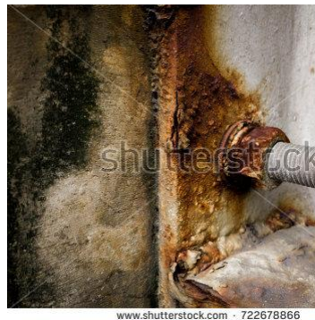
Şekil 1.4. Çelik yapılarda bulonlu ve kaynaklı birleşimde gözlenen korozyon hasarı ( https://www.shutterstock.com/image-photo/rust-corrosion-weldcorrosion-metalrust-metalscorrosion-rusted-722678866 )
