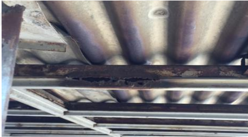
Şekil 1.1. Korozyon sonucu kesit kaybına uğramış çelik profil kiriş
