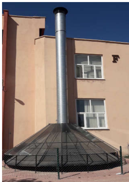
Şekil 3.1. Konya Teknik Üniversitesi güneş bacası sistemi
