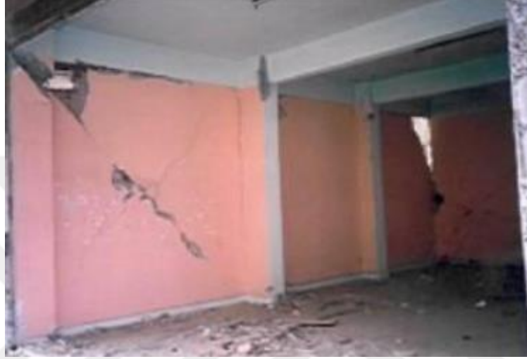
Şekil 3.2. Deprem nedeniyle dolgu duvarda oluşan hasar (Web iletisi 4)
