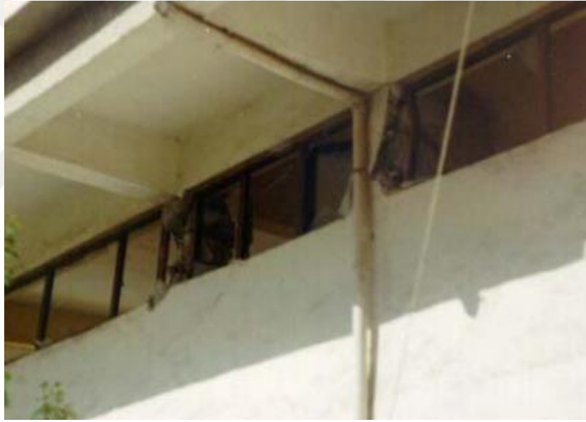
Şekil 3.4.Kısa kolon etkisi ile hasar gören bir yapı (Çağatay, 2007)
