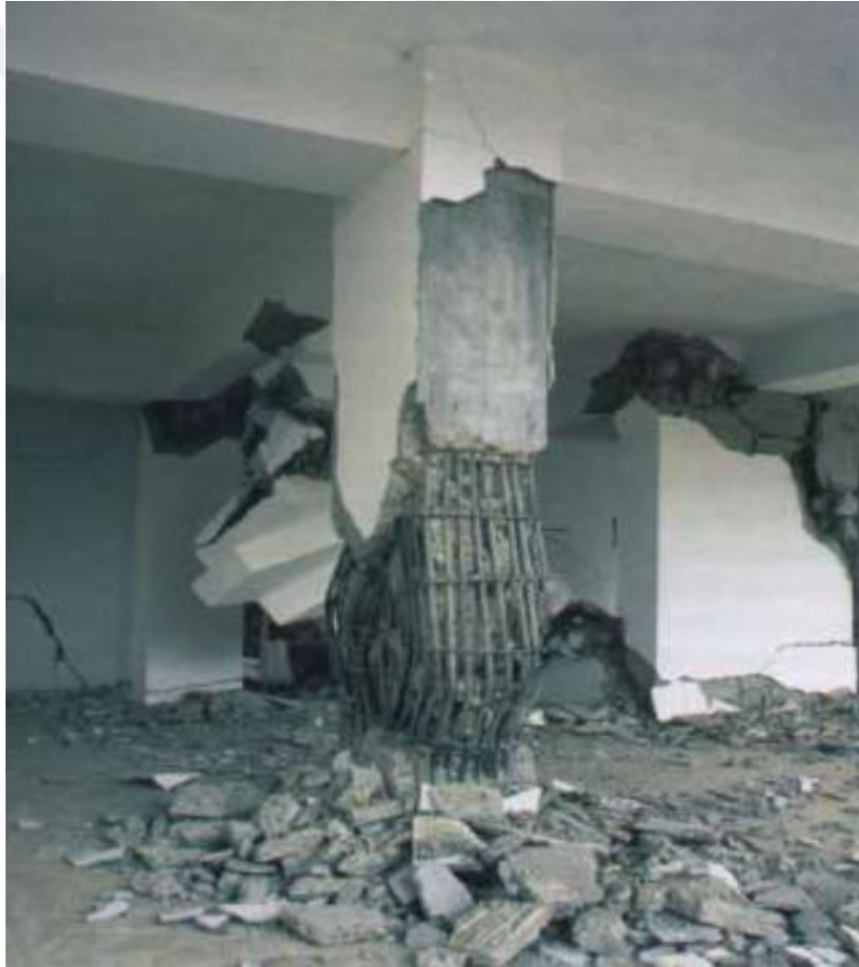
Şekil 3.5. Etriye sıklaştırması yapılmaması sonucu hasar gören bir kolon (Coza, 2003)
