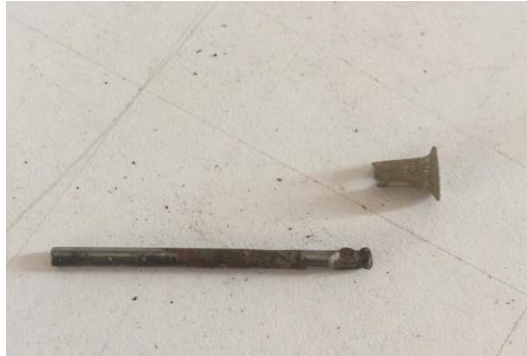
Şekil 4.34. Korozyona uğramış perçin
