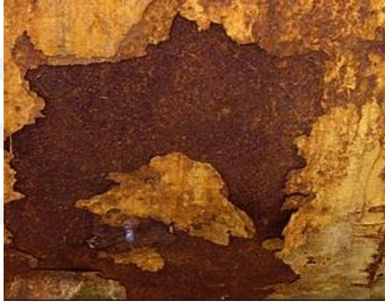
Şekil 1.34. Atmosferik korozyon örneği
