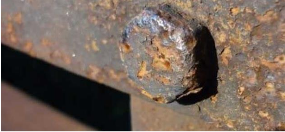
Şekil 1.27. Korozyona uğramış birleşim elemanı
