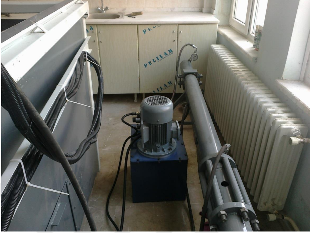
Şekil 3.10. Enjeksiyon haznesi ve enjeksiyon pompası
