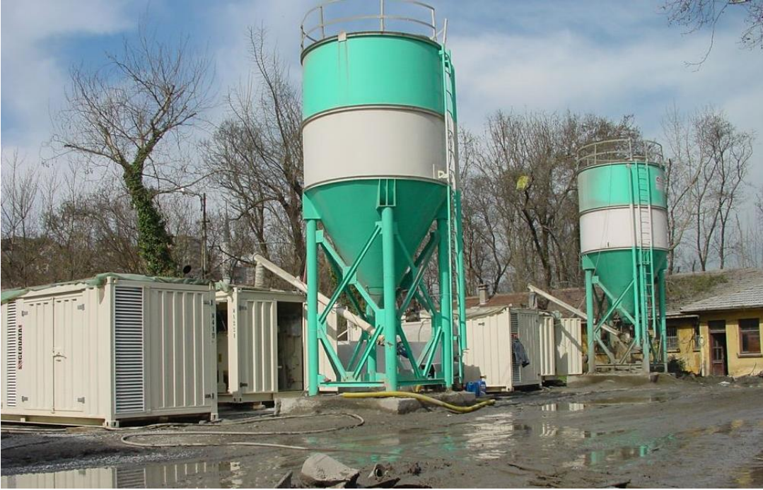
Şekil 2.8. Çimento silosu (geodata-url)
