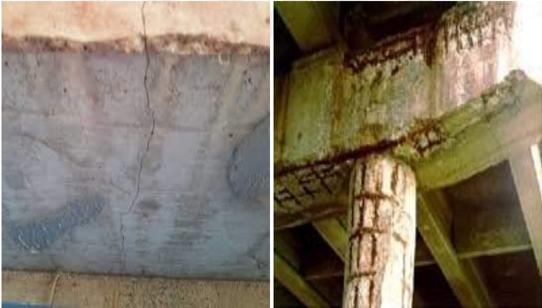
Şekil 3.20 Sülfat etkisine maruz kalmış yapı elemanları
