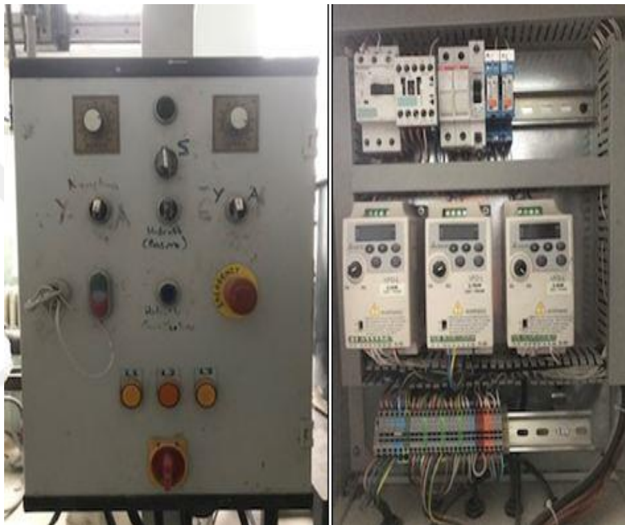
Şekil 3.32 Jet grout deney düzeneğinin kontrol paneli
