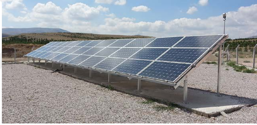
Şekil 5.1. Fotovoltaik enerji üretim tesisi
