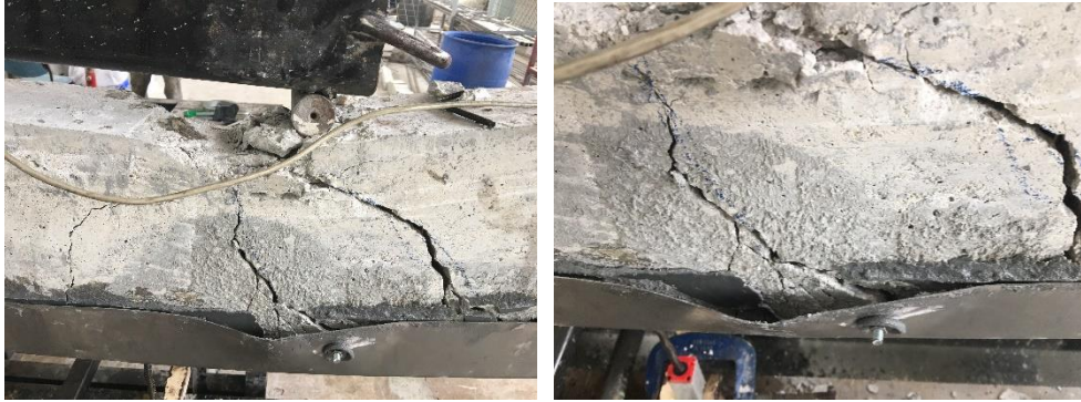
Şekil 4.38. Göçme anındaki ( BBS40mm-S ) nolu kiriş numune
