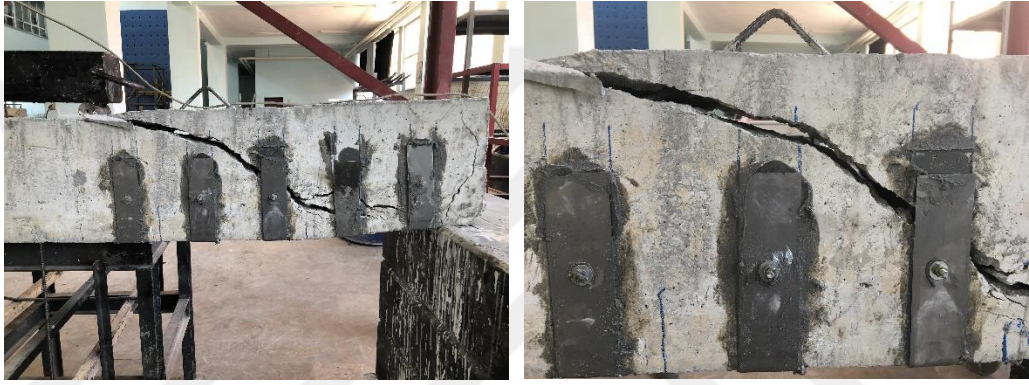
Şekil 4.65. Göçme anındaki ( SBS50kN-S ) nolu kiriş numune
