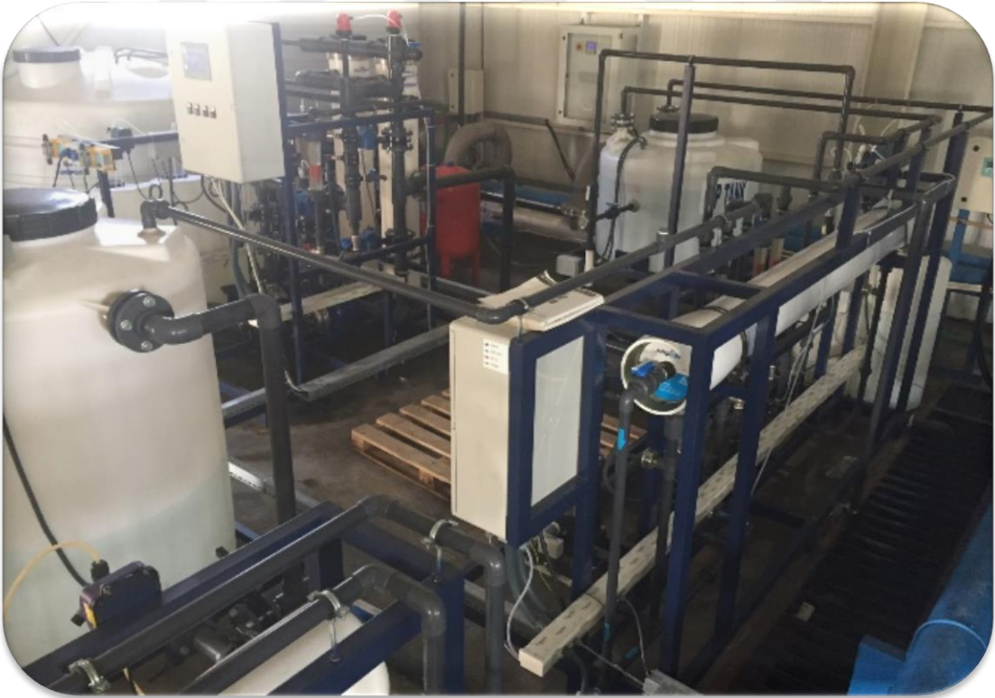
Şekil 3. 7. Pilot tesisin genel görüntüsü
