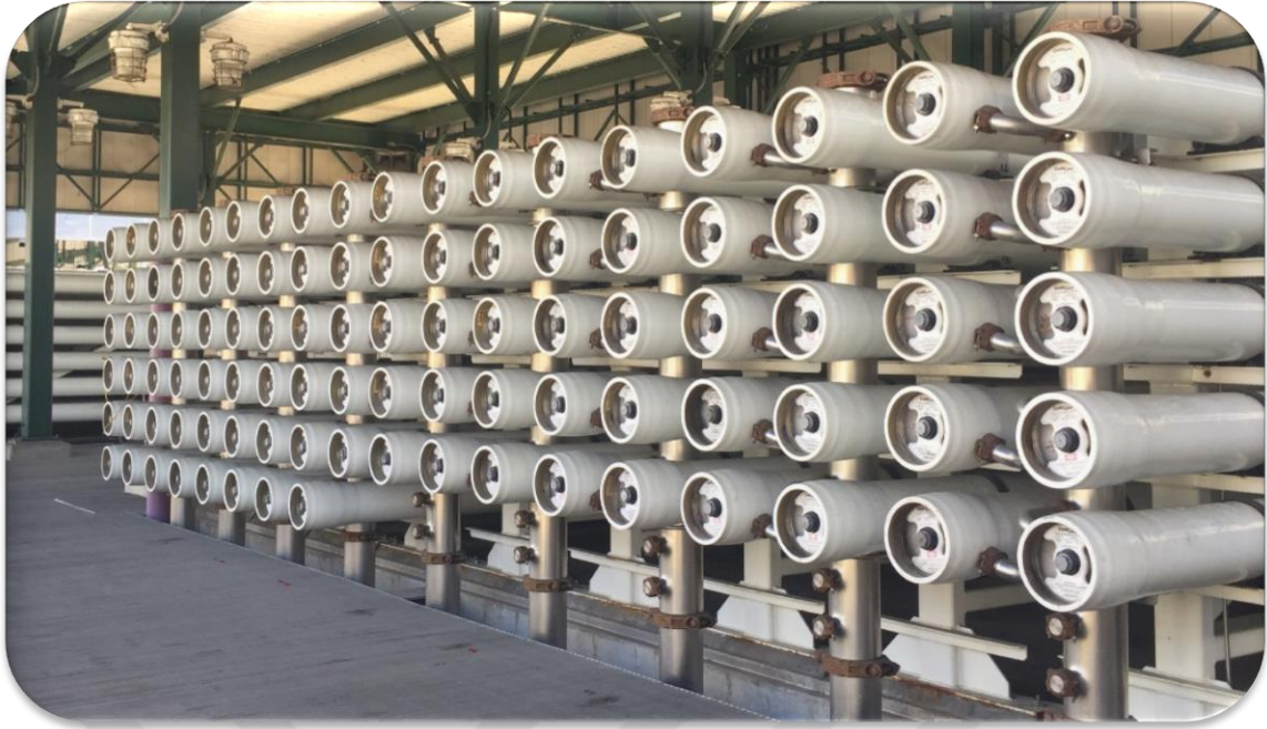
Şekil 2. 16. Atıksu Geri Kazanımı yapan Terminal Island AAT - RO Membran (Los Angeles, Amerika, 2017)
