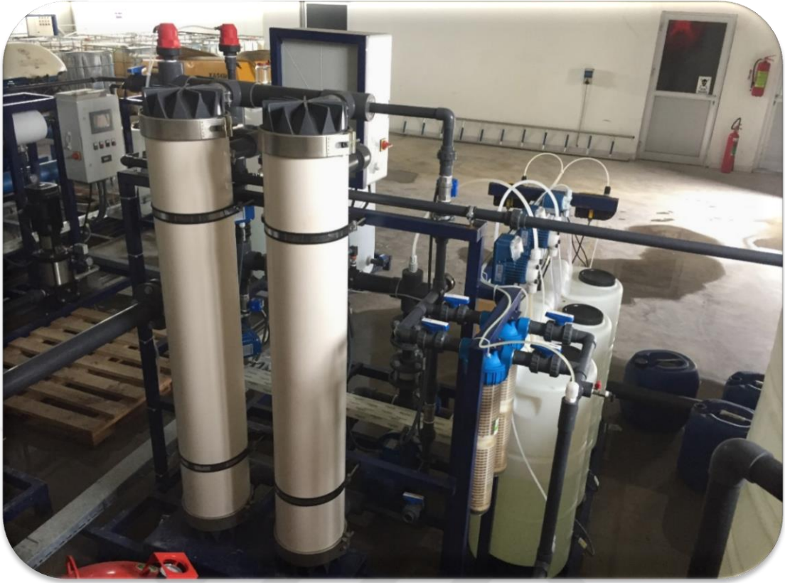
Şekil 3. 8. Pilot Tesis Ultrafiltrasyon (UF) Membran
