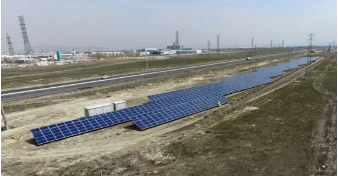
Şekil 4.9. Konya OSB 500 kW Güneş Enerjisi Santrali Görünümü
