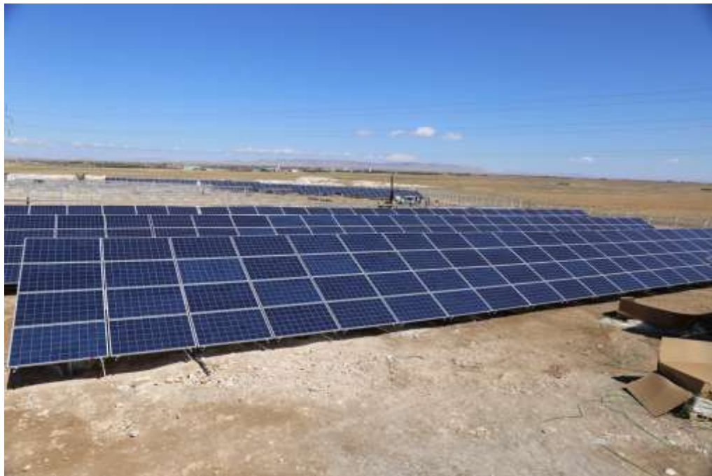
Şekil 4.4. Karaman Belediyesi 1000 kW Güneş Enerjisi Santrali Görünümü
