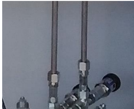
Şekil 4.10. Sistemde kullanılan iletim hattı boruları
