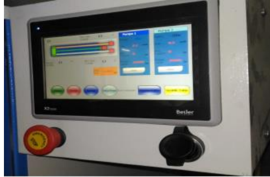
Şekil 4.24. PLC kontrol sistemi (Beijer Inc.)
