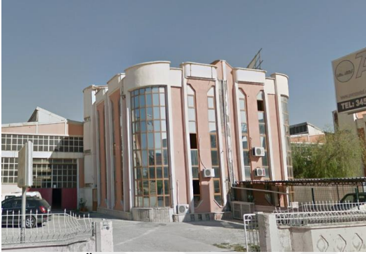
(c) Ön cephe dökülen sıva-boyalar
