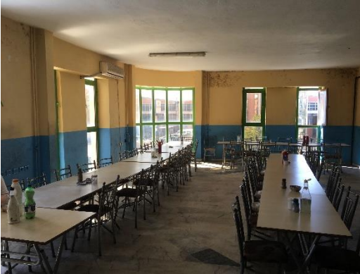
(e) Yalıtım olmayan duvarlarda oluşan küfler
