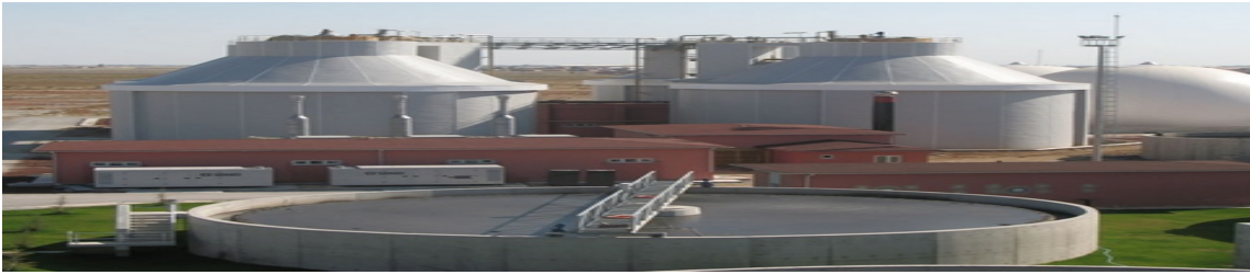
Şekil 3.8. Anaerobik çamur çürütücü
