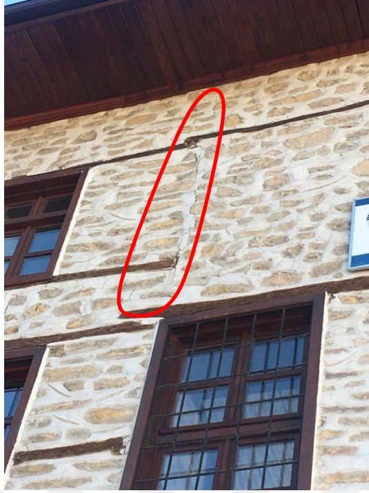
Şekil 6.58. Güney cephesindeki duvarda mevcut oluşan çatlak
