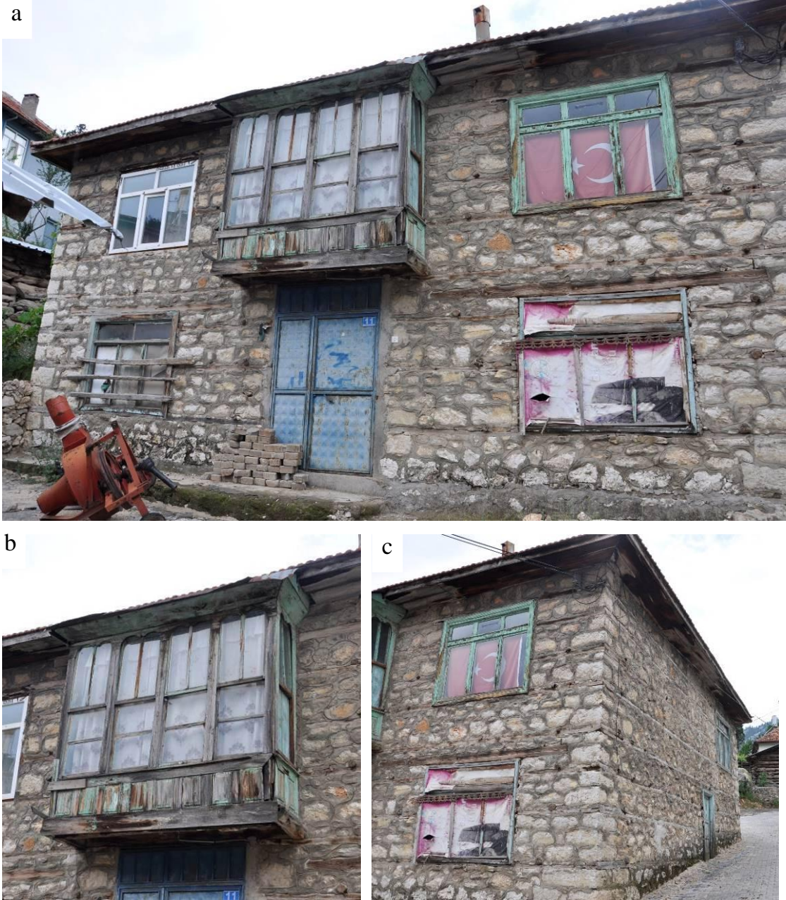
Şekil 6.1.26. 114 ada 50 parseldeki konut; a) doğu (giriş) cephesi, b) ahşap cumbası, c) kuzey cephesi.
