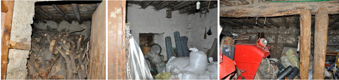
Şekil 6.2.29. Zemin kat; a) Odunluk, b) Z 02 nolu oda, c) Zemin kat sofasındaki ahşap dikmeler.
