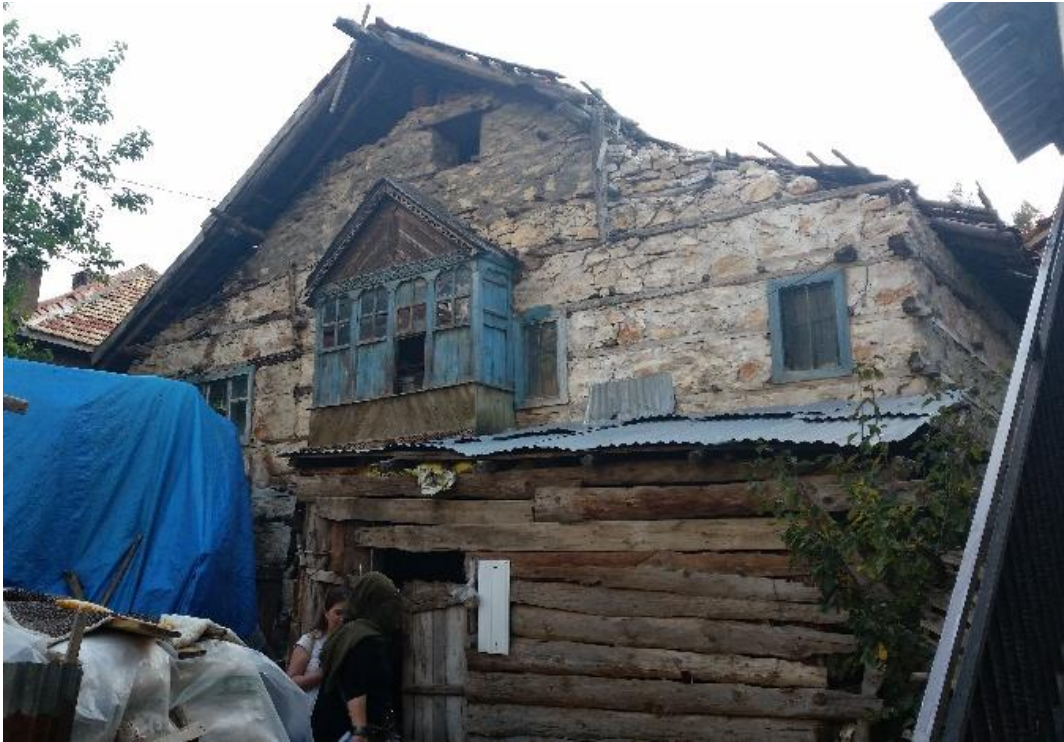
Şekil 6.1.74. 122 ada 4 parseldeki yıkılan konut ( Konya Büyükşehir Belediyesi, 2014)
