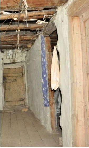
Şekil 5.3.34. 1 03 nolu oda girişi
