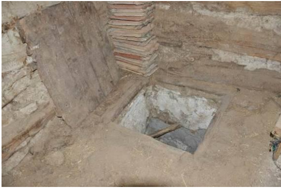
Şekil 4.34. 114 ada 80 parsel ahır ve samanlık bağlantısını sağlayan boşluk
