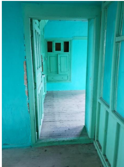
Şekil 4.7.27. Oda 103 giriş kapısı
