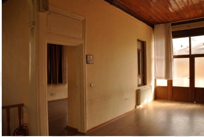
Şekil 4.8.38. Oda 102 giriş kapısı
