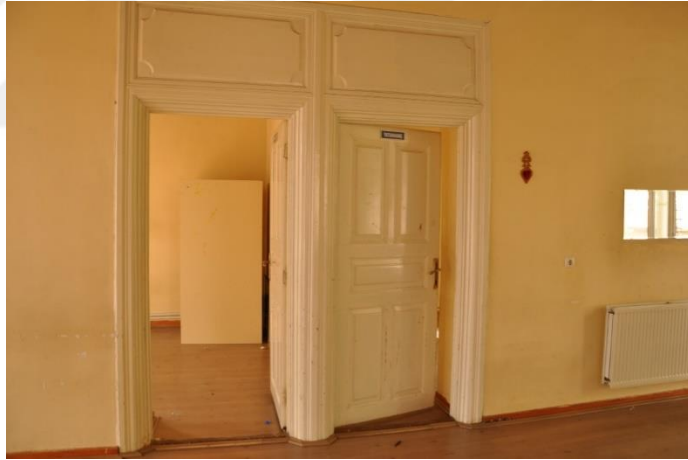
Şekil 4.8.42. Oda 104 giriş kapısı
