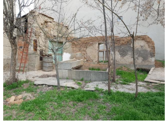
Şekil 4.7.41. Aşhane duvar ve Oluk
