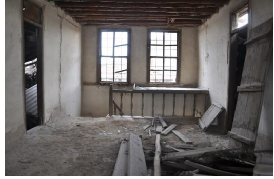
Şekil 4.5.36. Sofa güney cephe pencereleri
