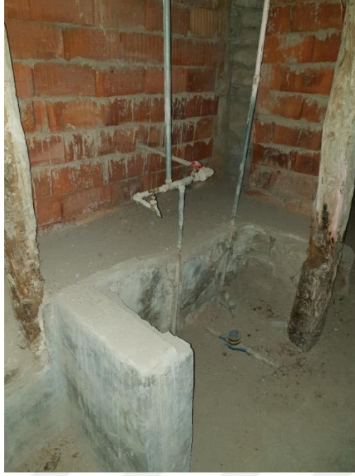
Şekil 4.4.24. Zemin kat koridor su ünitesi
