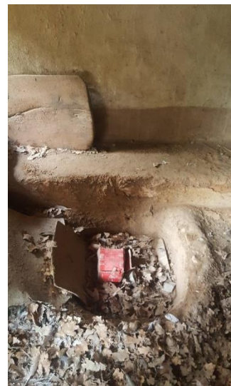
Şekil 4.5.6. Bodrum zeminindeki çukur
