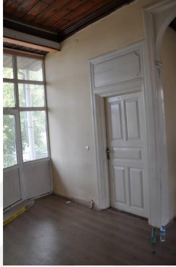
Şekil 4.8.45. Oda 105 giriş kapısı
