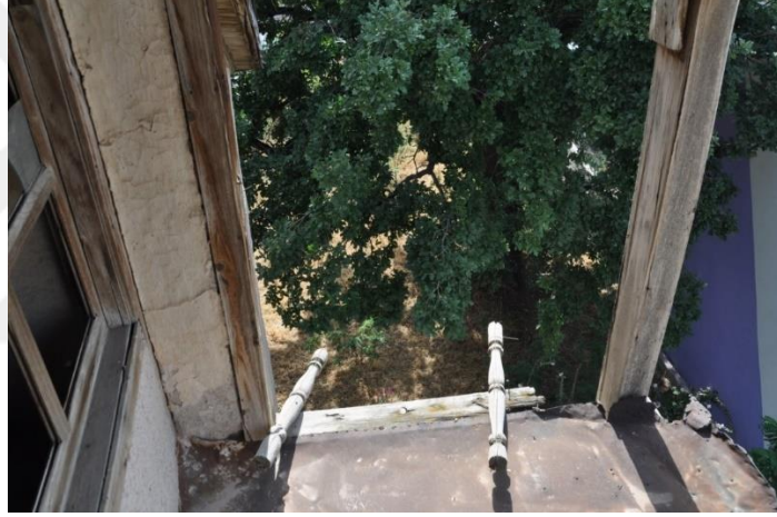
Şekil 4.5.33. Balkon zemin ve sökülmüş korkulukları
