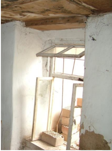
Şekil 4.3.8. Zemin kat gd oda penceresi
