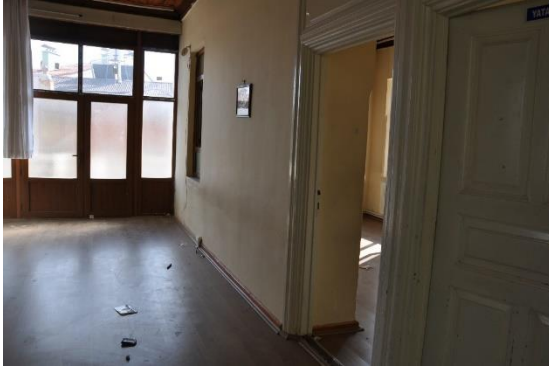
Şekil 4.8.40. Oda 103 giriş kapısı
