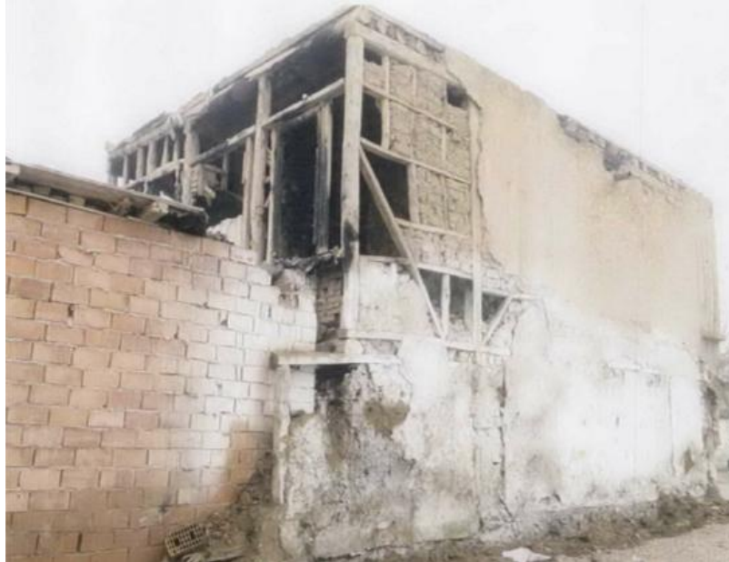
Şekil 5.7.3.2. Yapıdaki hasarlar (Rölöve raporu- CRY Mimarlık)
