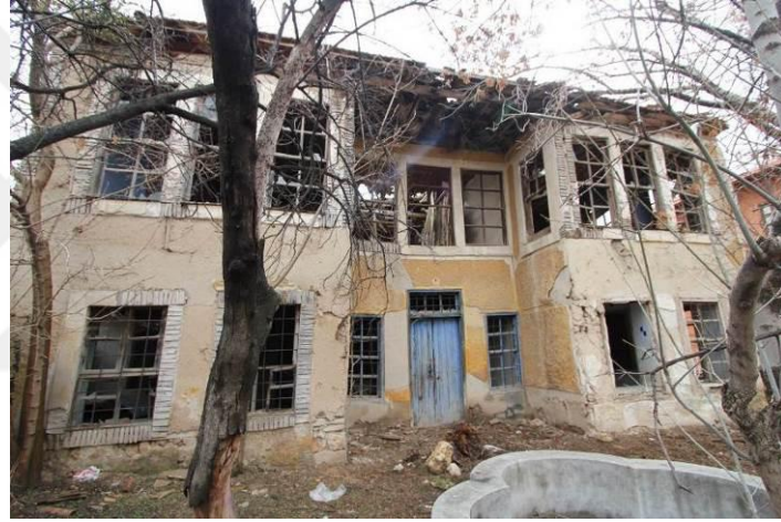
Şekil 5.8.6.2. Yapının kuzey cephesindeki bozulmalar (Rölöve raporu-Mostar Mimarlık)
