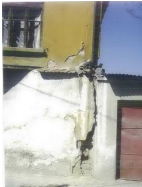
Şekil 5.4.6.4. Çıkma ve beden duvarında görülen bozulma (KKVKBK arşivi)
