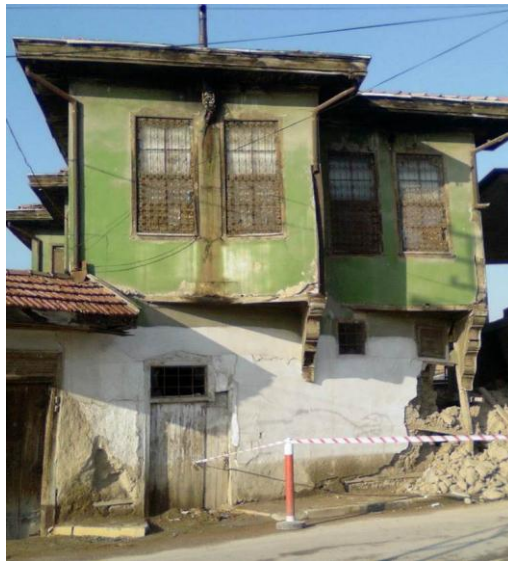
Şekil 5.5.6.3. Yapıda meydana gelen hasarlar (KKVKBK arşivi)
