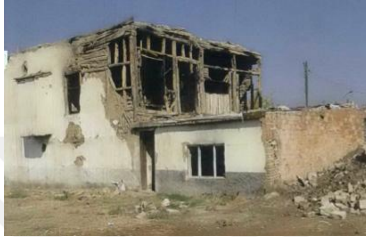
řekil 5.7.2.2. Yapının yangın sonrası hali (Rlve raporu- CRY Mimarlık)
