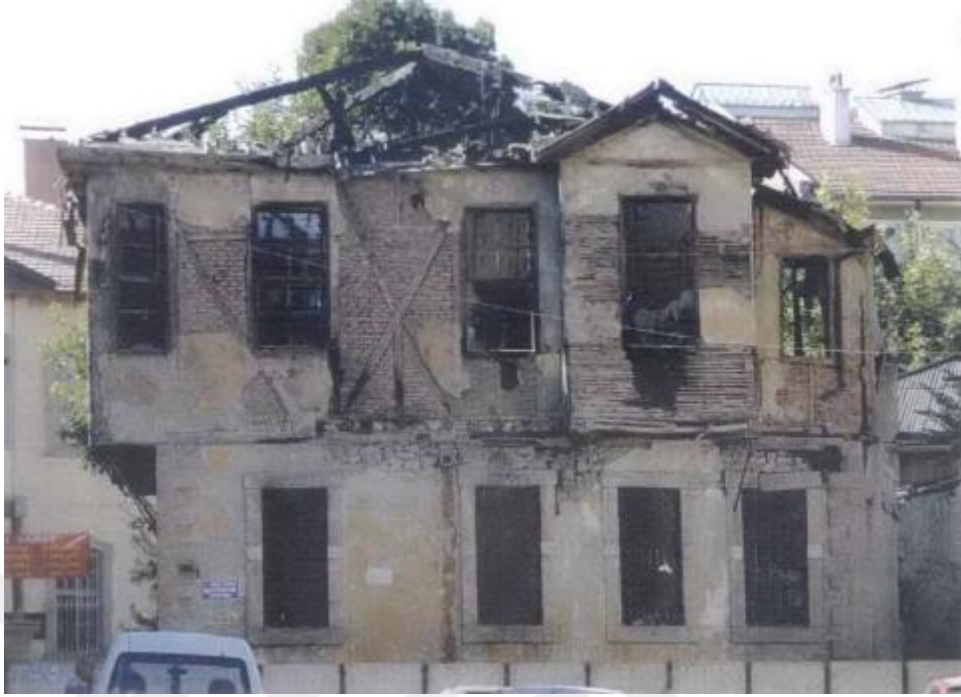
Şekil 5.6.3.1. Yapının yangından sonraki hali (KKVKBK arşivi)
