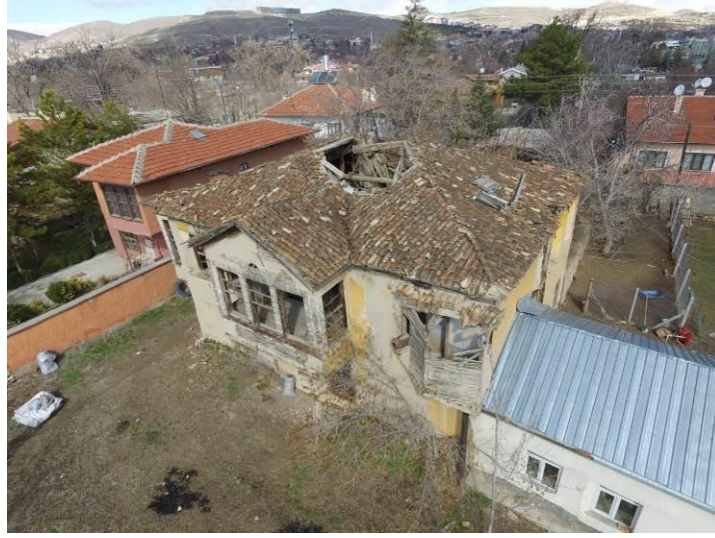
Şekil 5.8.6.1. Yapının üst örtüsündeki hasar (Rölöve raporu-Mostar Mimarlık)
