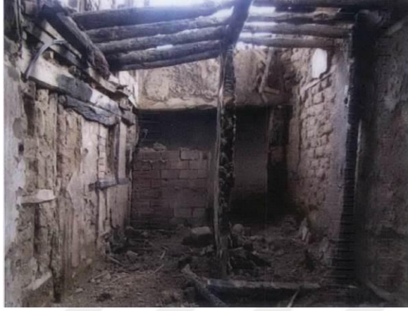
Şekil 5.7.3.1. Yapının yangında zarar gören ahşap taşıyıcıları (Rölöve raporu- CRY Mimarlık)
