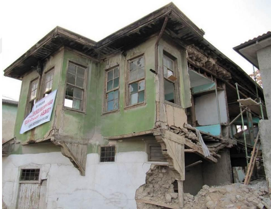
Şekil 5.2.4.4. Yapının doğu cephesi çıkmaları ve yıkılan kuzey cephesi (KBB arşivi)
