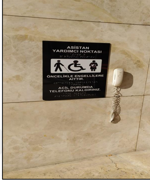
Şekil 4.28. Gar içerisinde bulunan asistan yardımcı noktası telefonu
