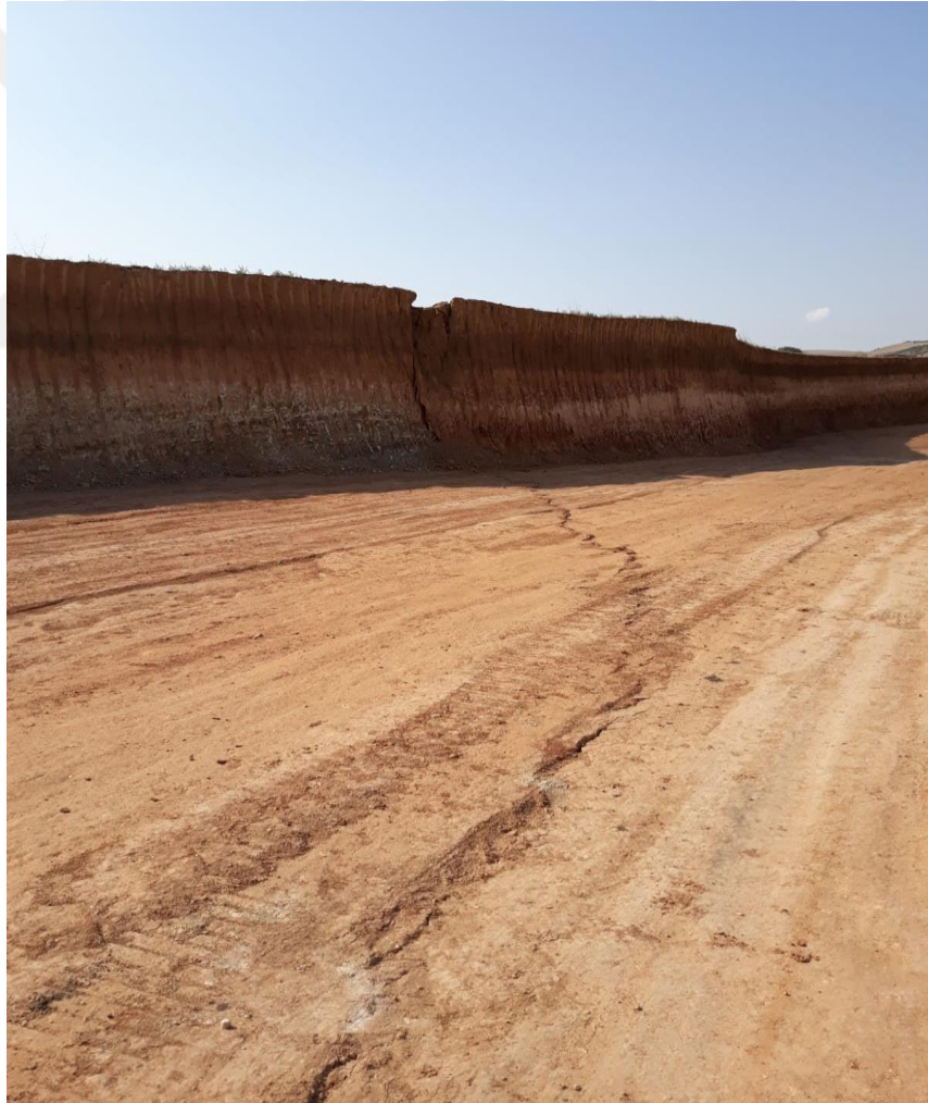
Şekil 3.4. Maden sahasında oluşan bir gerilim çatlığı
