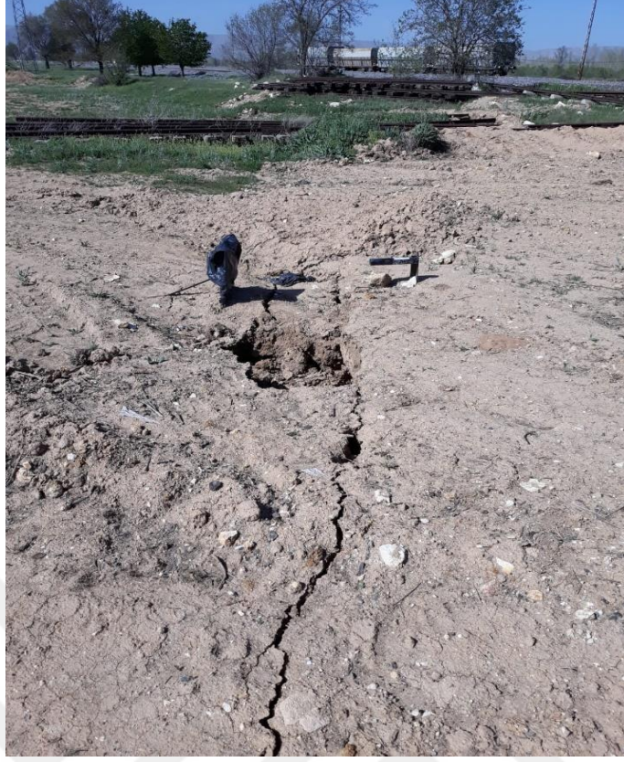
Şekil 3.5. Ölçüm alanındaki gerilim çatlağı
