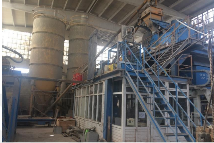
Şekil 4.8. Üretim alanı çimento siloları
