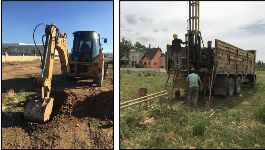
Şekil 6.2. AÇ-1 numaralı araştırma çukuru ve SK-2 numaralı jeoteknik sondaj kuyusu çalışmasından bir görüntü
