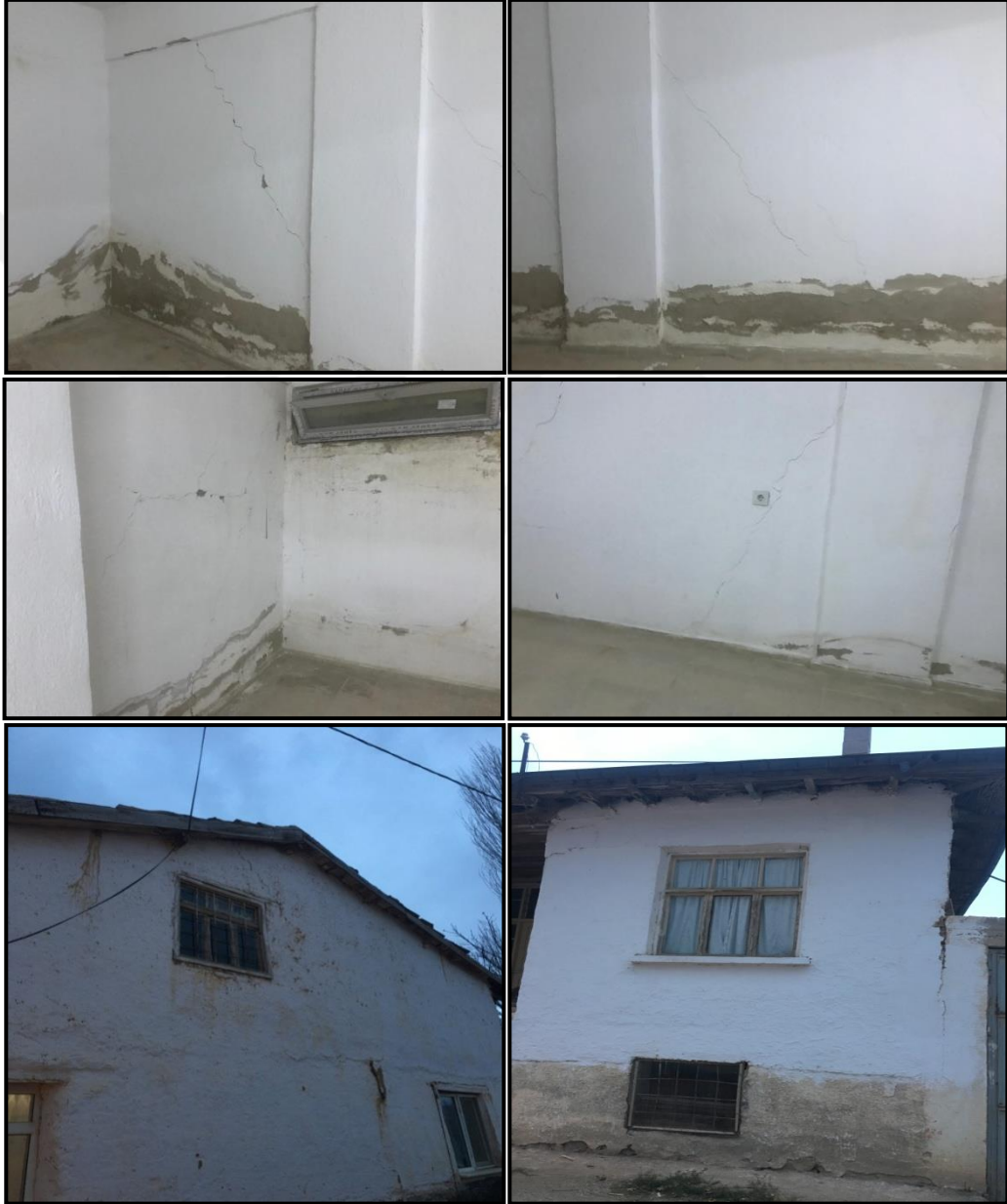
Şekil 7.1. İnceleme alanında mevcut yapılarda meydana gelen zemin problemlerine bağlı hasarlar
