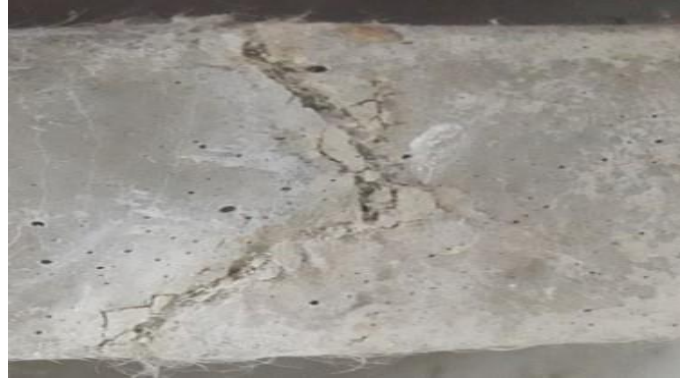
(a) Lokalize olmuş çatlak
