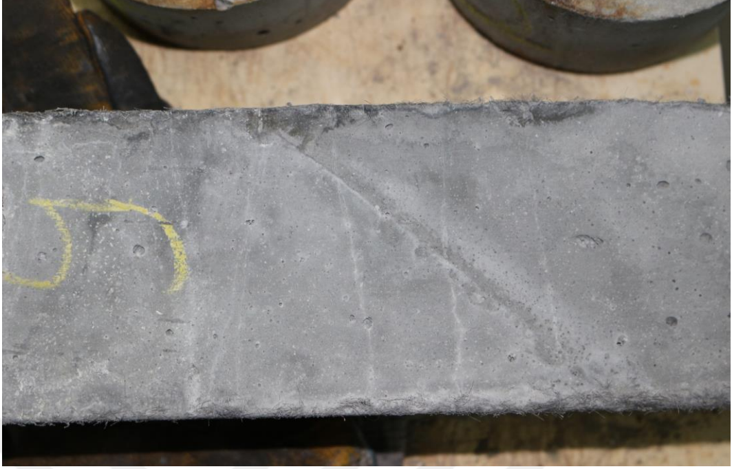
Şekil 4.63 Hasar verilmiş ECC-KNT kiriş numunelerinin kendiliğinden iyileşmiş dar açıklıklı çoklu çatlakları
