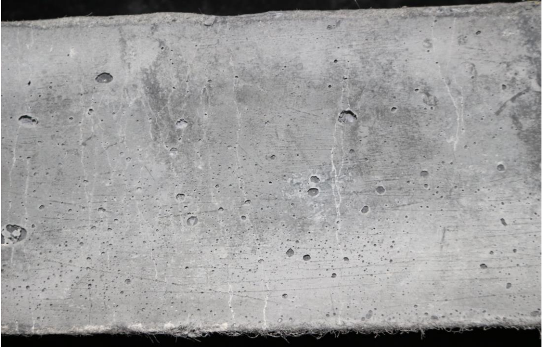
Şekil 4.65 Hasarlı ECC-KNT/NS kiriş numunesinin kendiliğinden iyileşmiş çoklu çatlakları
