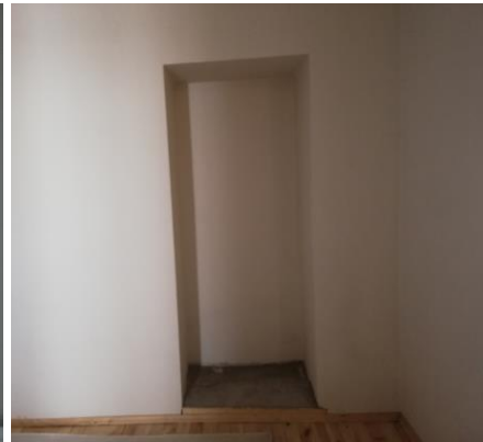
Şekil 4.75. Lojman -Su Deposu Duvarı
