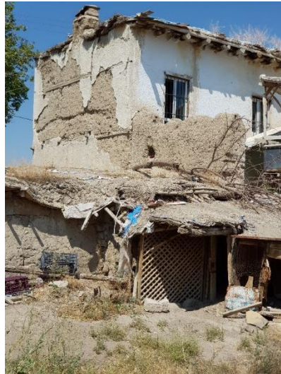
Şekil 3.71. Cephedeki sıva dökülmeleri (E.AKMAN Arşivi, 2018)
