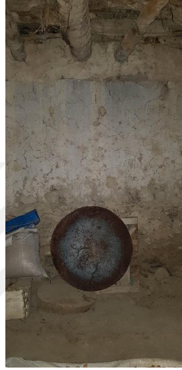
Şekil 3.237. Duvardaki sıva ve boya dökülmeleri (E.AKMAN Arşivi, 2018)
