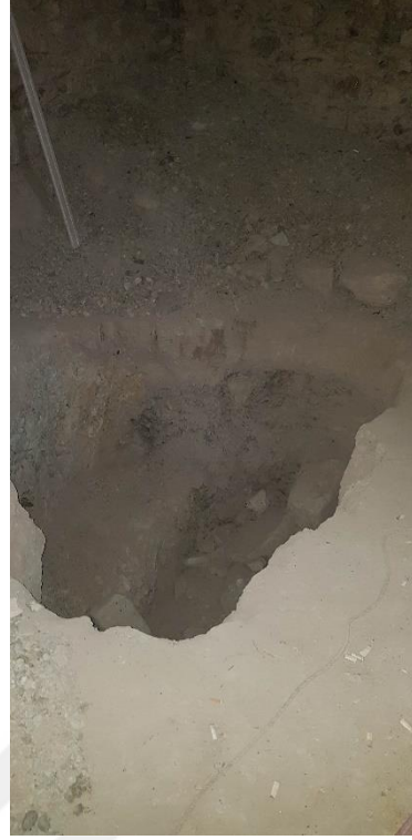
Şekil 3.227. Odanın zeminindeki göçük (E.AKMAN Arşivi, 2018)
