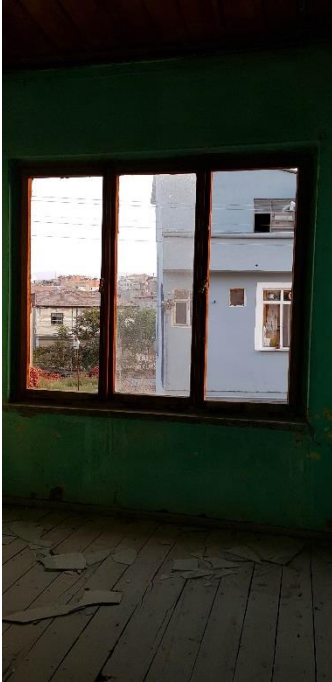
Şekil 3.198. Güneybatıdaki pencere (E.AKMAN Arşivi, 2018)
