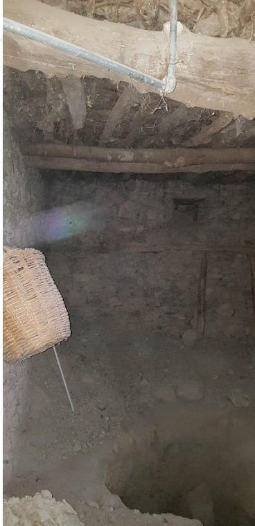
Şekil 3.228. Odanın zeminindeki göçük (E.AKMAN Arşivi, 2018)
