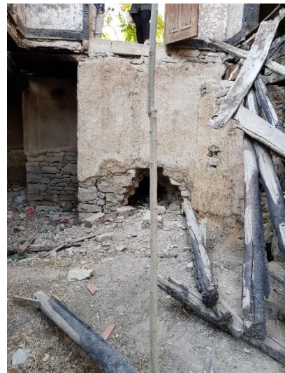
Şekil 3.85. Moloz taş duvar üzeri sıva (E.AKMAN Arşivi, 2018)
