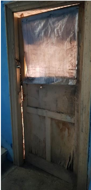
Şekil 3.129. Açılmayan ahşap kapı (E.AKMAN Arşivi, 2018)
