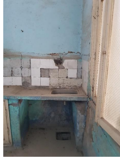
Şekil 3.16. Beton tezgâh ve lavabo (E.AKMAN Arşivi, 2018)
