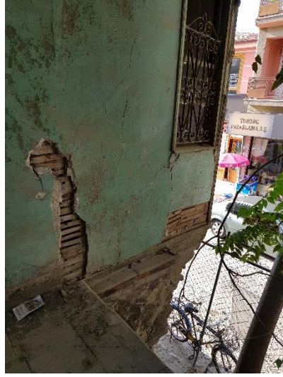
Şekil 3.111. Giriş cephesi sıva dökülmeleri (E.AKMAN Arşivi, 2018)
