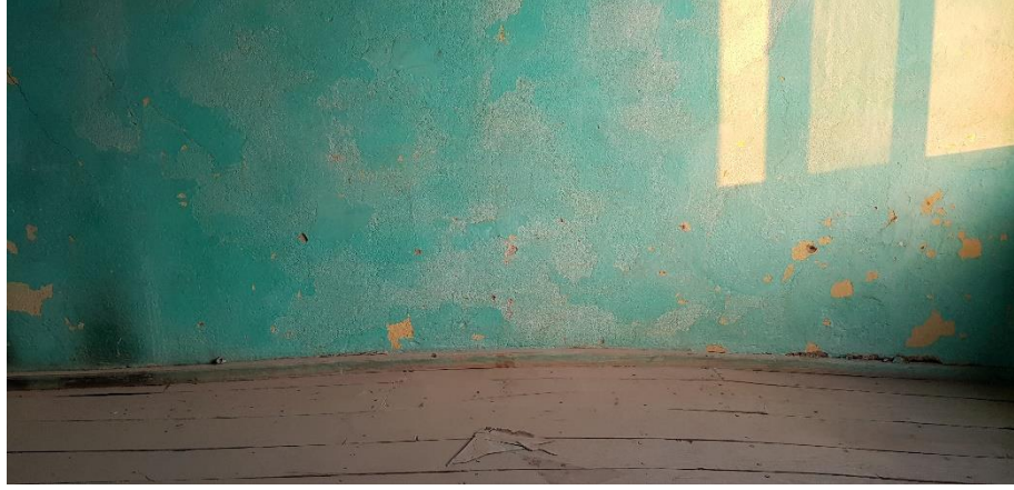
Şekil 3.200. Odanın deforme olan döşemesi (E.AKMAN Arşivi, 2018)
