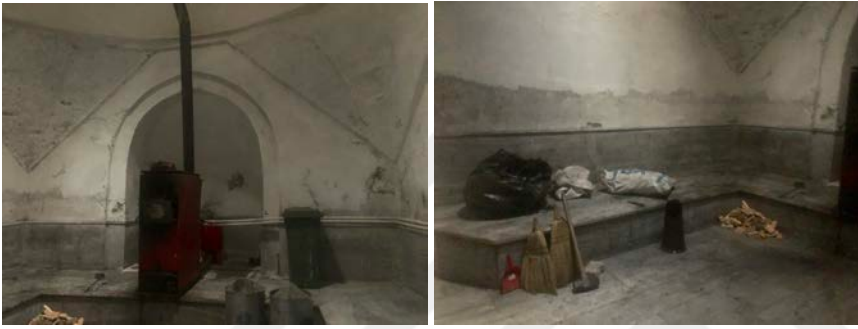
Şekil 4.31. Hasbeyoğlu Hamamı kadınlar soğukluk bölümü eyvanı ve kubbeye geçiş elemanları (Kişisel Arşiv).
