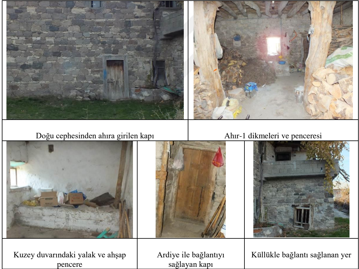
Şekil 4.92. Bekir Demirtaş evi Ahır-1, Ahır-2, girilemeyen ardiye ve küllük
