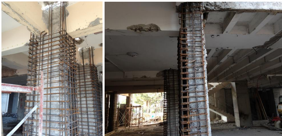
Şekil 2.9. Kolonları betonarme mantolama ile güçlendirme örneği (Bawary, 2018)
