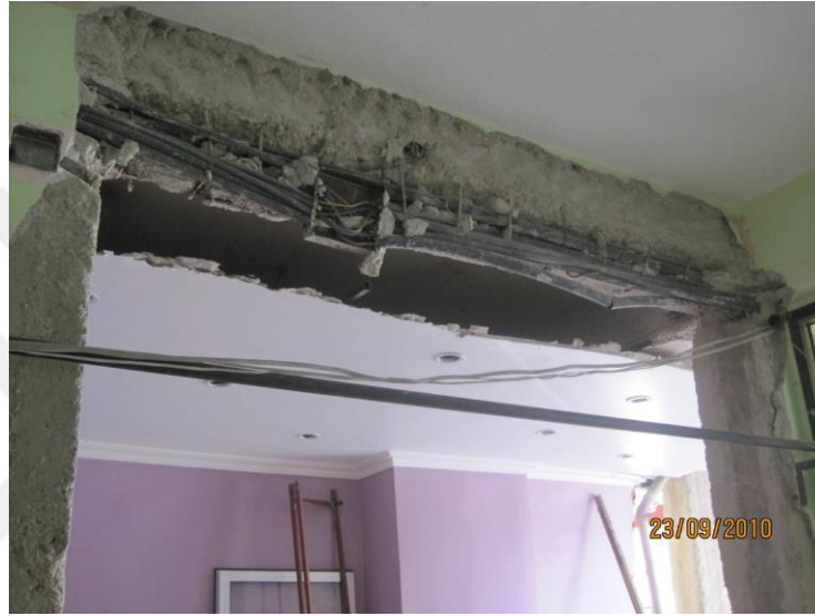
Şekil 3.26. Teknik denetim eksikliği sonucu kiriş içinden geçen tesisat kabloları (Bayraktar, 2011)
