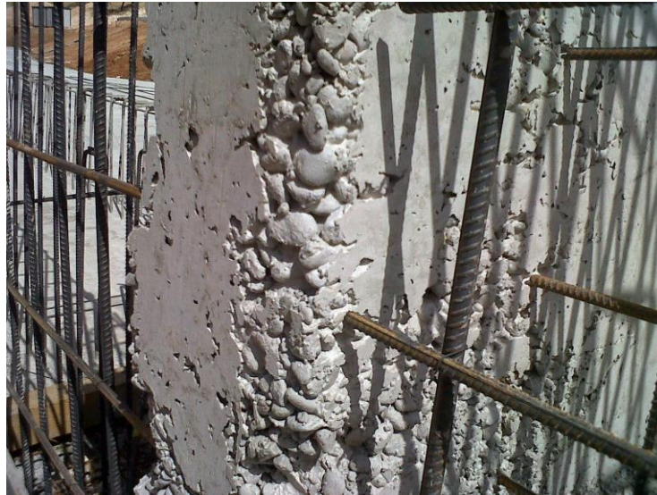
Şekil 2.1. Uygulama sırasındaki eksiklikler sonucu oluşan segregasyon (Web2)
