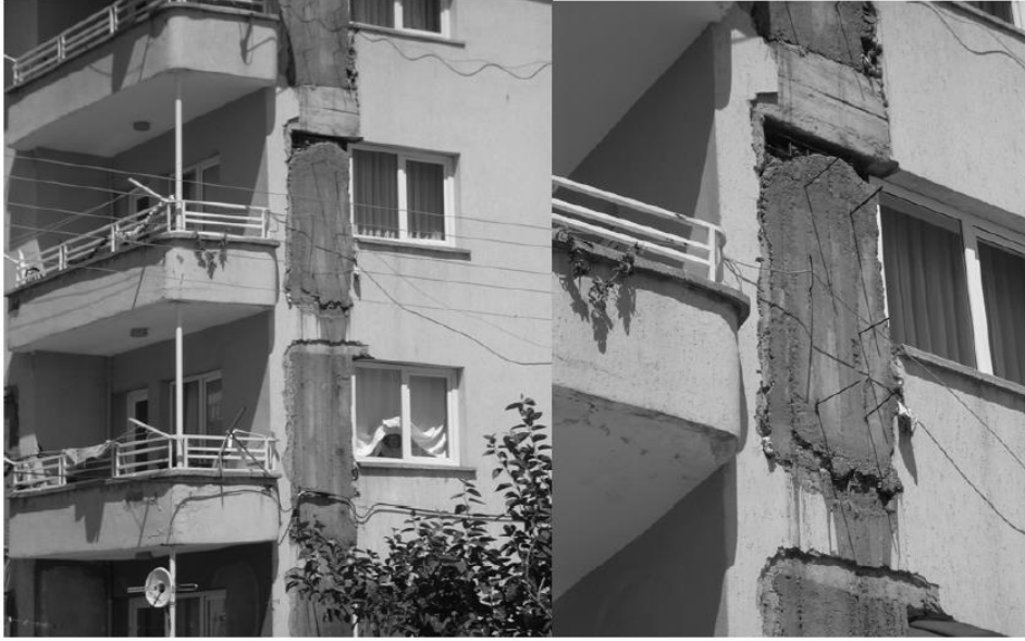
Şekil 2.6. Yanlış güçlendirme yapılan kolonlar ve binanın genel görünüşü (Gülmez, 2010)
