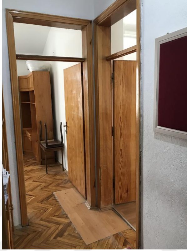
Şekil 3.17. Kolonların mantolanması sonucu açılan döşemede malzeme farkı (Korkmaz arşivi, 2019)
