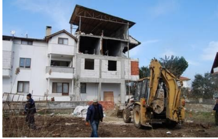
Şekil 2.4. Yarıya kaçak kat eklenmesi (Web3)
